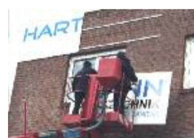
Unübersehbar: das Unternehmen Hartmann Haustechnik ist jetzt am König-Georg-Stieg in Wilhelmsburg zu Hause, direkt hinter den Elbbrücken (aus Süden kommend). Hier wird der Schriftzug am Haus montiert.
